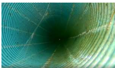
VUE INTÉRIEURE DE L'INFILTRATUBE
