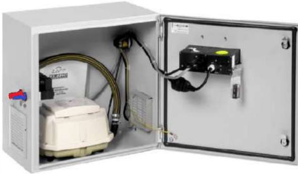
Armoire interne métallique
